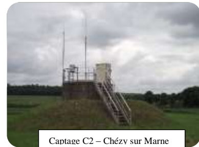
Captage C2 – Chézy sur Marne
