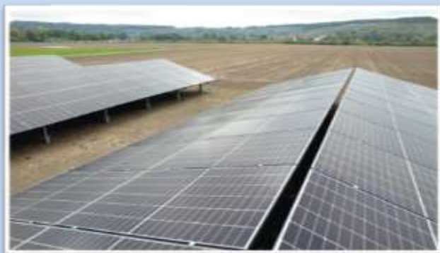
Panneaux photovoltaïque – Usine de Chézy sur Marne
